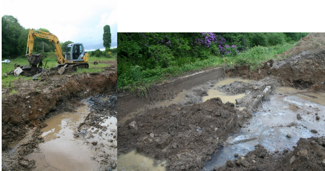
Mise à nu de canalisations et des fonds intacts des bassins de la pisciculture. Les murs avaient été partiellement démantelés et laissés sur place.
