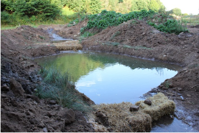
Bassin de décantation récepteur des eaux s'écoulant sur le site avant rejet dans le cours d'eau.
