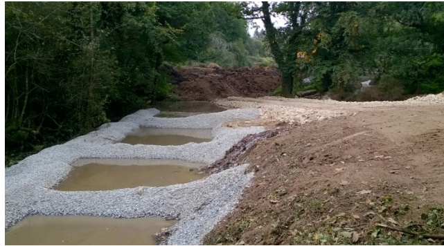
Filtre de graviers sur série de bassins de décantation
